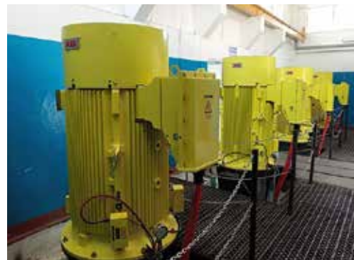
New Pumps at Kafue Intake.
