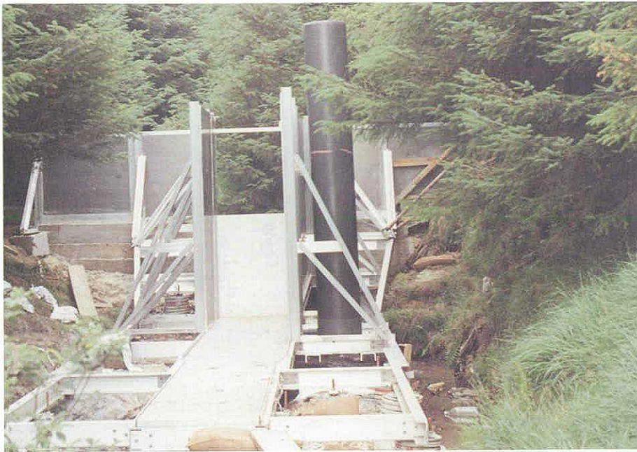
Reusable aluminium flow structure being installed in the Llyn Brianne catchment, central Wales. Installation d'un ouvrage de régulation réutilisable en aluminium dans le bassin versant de Llyn Brianne, dans le centre du Pays de Galles.
